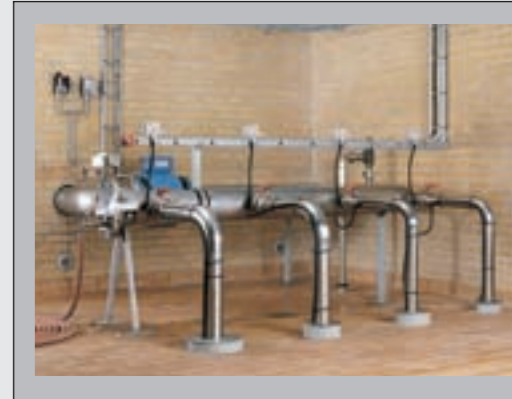
Mehrere Pumpen, die Wasser aus unterirdischen Kavernen fördern
